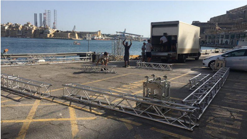
Trusssystem für Bühnendach
